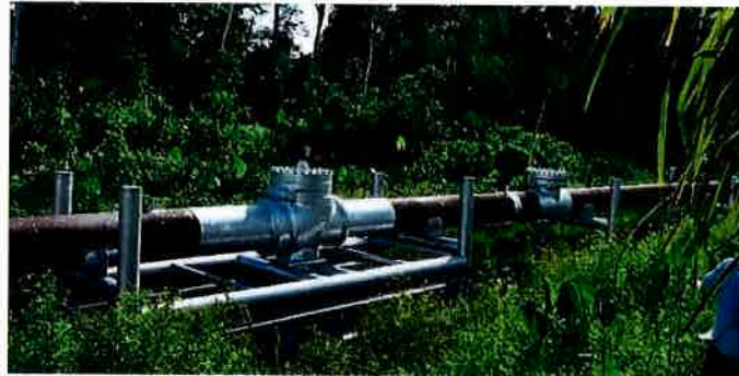
Figura 1 Progresiva km 177 del ORN, válvula check
