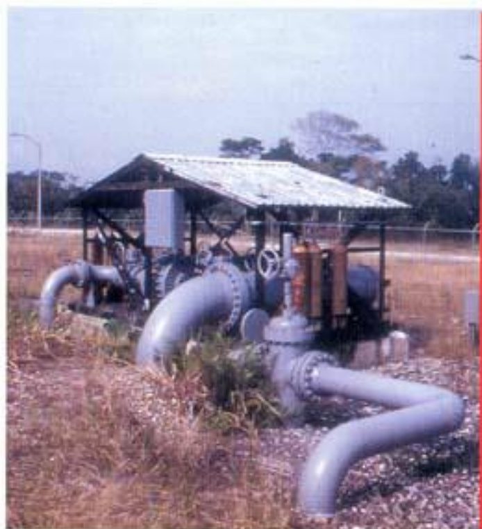
Sistema de alivio, Estación N° 5, Oleoducto Norperuano.
